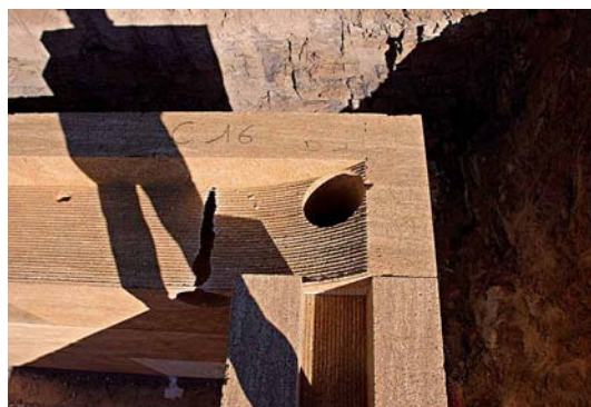
Détail sur les angles de murs, avec le carottage réalisé pour le coulage des raidisseurs verticaux en béton afin de répondre aux normes parasismiques.
